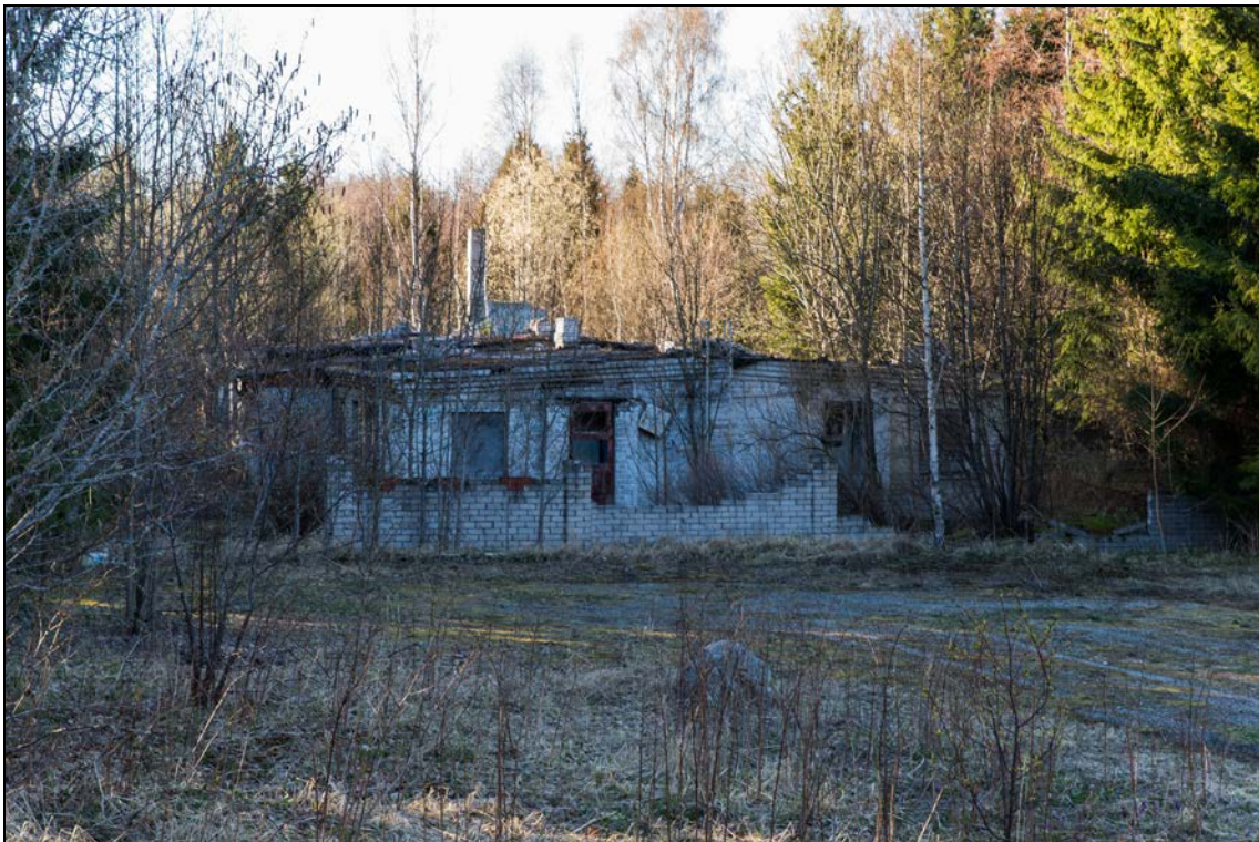
Foto 6 (223). Tsitre kordon. Peahoone [2], vaade sissesõidutee poolt. Esiplaanil varisenud tellismüür.
